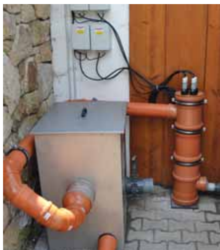
Obr. 5: instalace do potrubního systému před štěrbinový předfiltr
